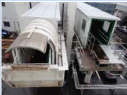
人道橋の船側設備(左)と 陸側設備(右)
